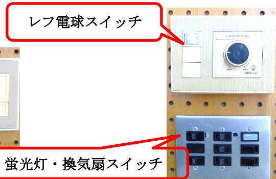
【研修室の電灯スイッチ】
