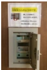
【宿泊室のエアコン操作盤】
