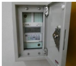
【談話室のエアコン操作盤】
