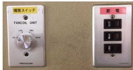
【宿泊室のファンコイルユニットスイッチ】
